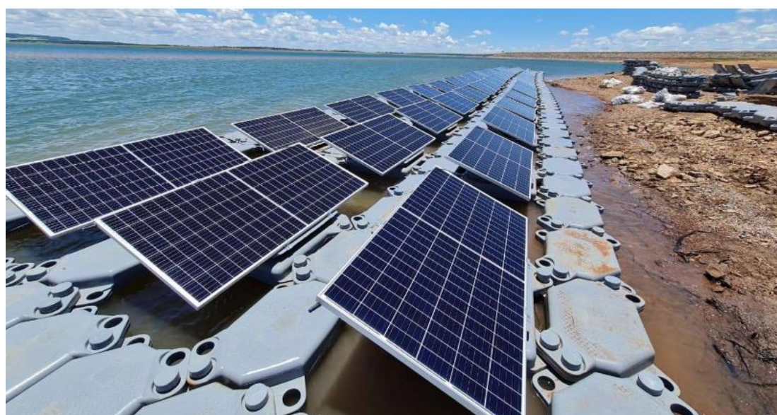
Figura 58. Planta fotovoltaica. Fuente: Furnas, 2021.
